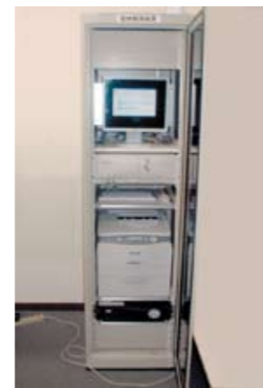
堤体観測装置
